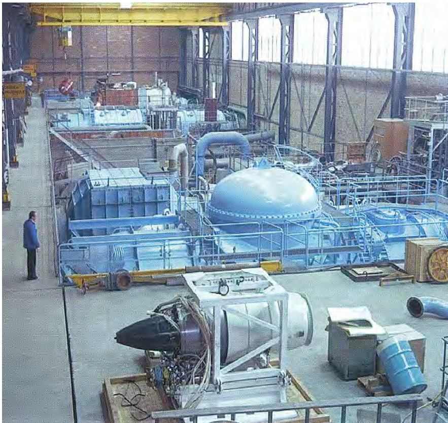
Fig. 10 Les caissons R3, R4, R5 et R6 au Hall nord du bâtiment B
